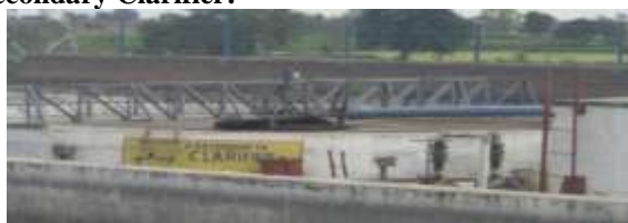
Fig.no. Secondary clarifier
